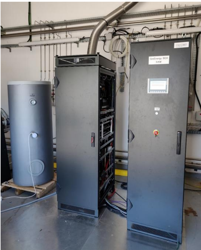
GreEnergy Box™ d'HELION Hydrogen Power connectée au data center vert
